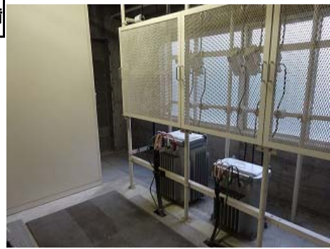
【体育館・課外活動施設】電気室 経年 劣化状況 電気設備C 経年36年
