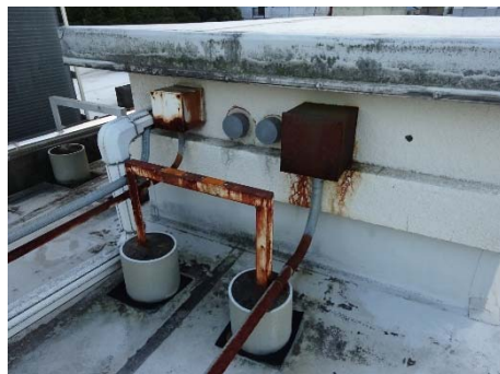
【医理工共用施設】配管・架台劣化状況 機械設備C 経年34年
