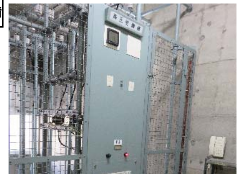
【教育学部D棟】未更新開放型高圧盤 経年50年
