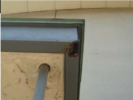
【体育館(体操場)】軒樋劣化損傷状況 外壁C 経年35年
