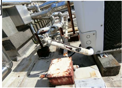
【本部管理棟】冷媒配管ほか劣化状況 屋上C 経年39年
