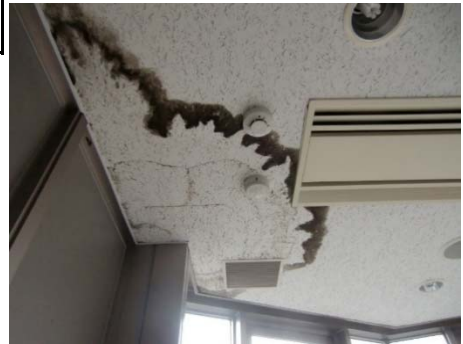
【8号館S棟】9階天井漏水あと状況 屋上C 経年20年
