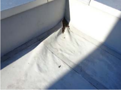
【A棟(研究・産学連携推進機構)】屋上防水浮き状況 屋上D 経年29年
