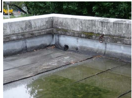
【刀城会館】露出アスファルト防止劣化状 況 屋上D 経年44年
