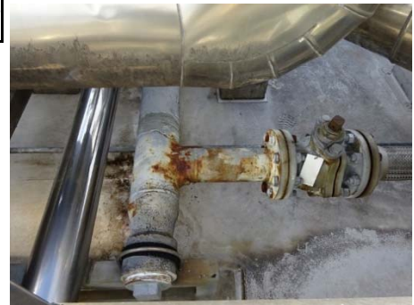
【8号館S棟】屋上配管劣化状況 機械設備C 経年20年
