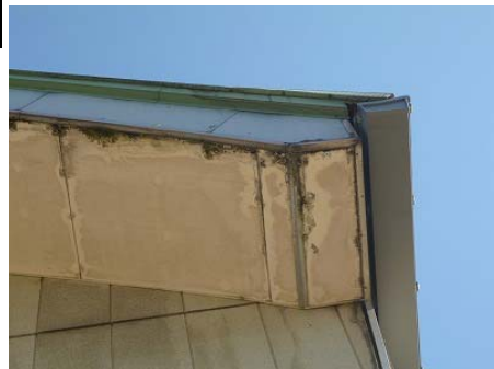
【体育館(体操場)】軒の劣化損傷状況 外壁C 経年35年
