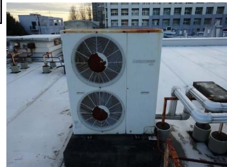
【医理工共用施設】室外機劣化状況 機械設備C 経年34年
