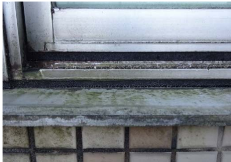
【医理工共用施設】外壁クラック・建具シーリング劣化状況 外壁C 経年34
