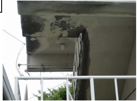
【体育館・課外活動施設】外部階段 軒 裏 塗装劣化状況 外壁D 経年36年
