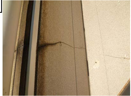
【体育館(体操場)】外壁仕上げ材のひび割れ状況 外壁C 経年35年
