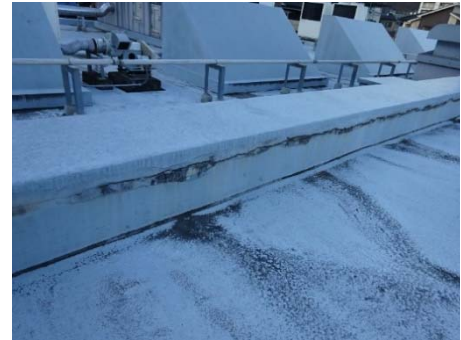
【原動機棟】屋上立上りクラック状況 屋上C 経年16年
