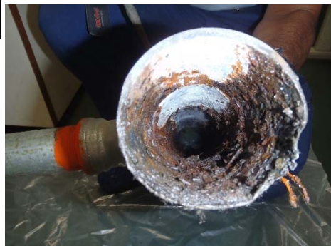
【教育学部N棟】排水管劣化状況 機械設備C 経年37年
