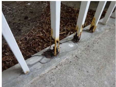
【保健学科中央棟】外部手すり 錆発 生状況 外壁B 経年45年
