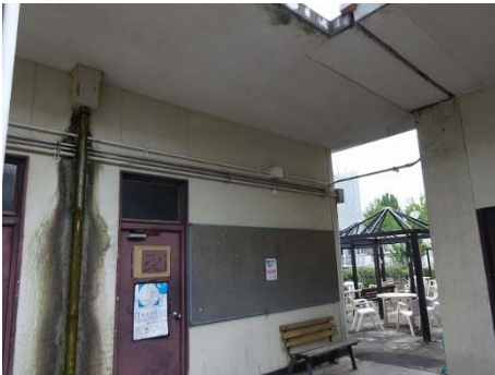
【学生食堂】樋腐食漏水状況 外壁C 経年25年
