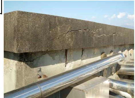
【本部管理棟】コンクリート劣化鉄筋錆状況 屋上C 経年39年
