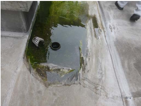
【中央機械室】防水亀裂劣化状況 屋上D 経年31年
